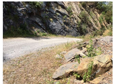
Blocs sur le bas côté de la piste forestière du Val. La falaise est visible depuis le village. (Photo : C-PRIM)
