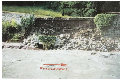
Mur détruit à proximité du pont de Camous.
