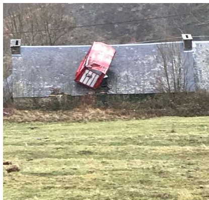
Une bétailère rouge s'est retrouvée sur le toit d'une grange à Aspin-Aure lors des intempéries du 13 décembre 2019 (Photo : Mairie Aspin-Aure)
