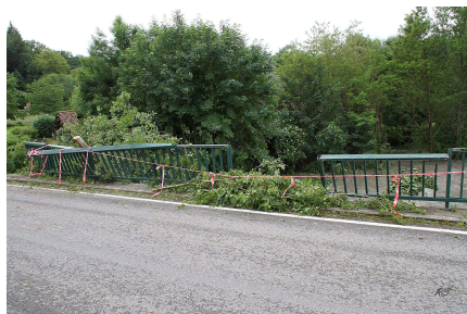
Les barrières du pont d'Anères après la crue de 2013
