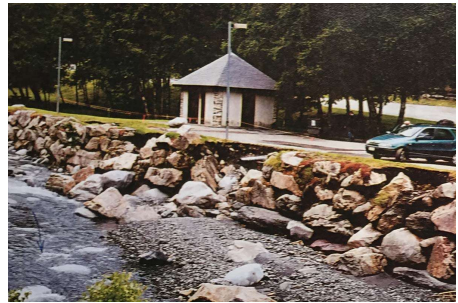
Enrochements endommagés près du camping du Moudang après la crue de juillet 2001 (photo : ONF-RTM)
